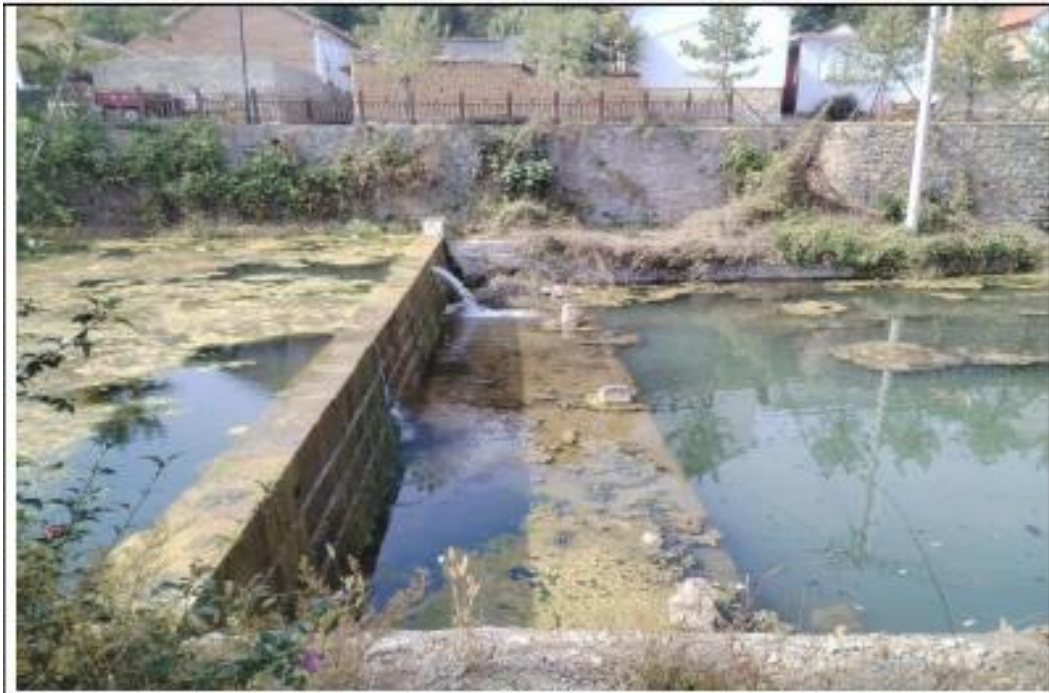
拦砂坎现状照片
