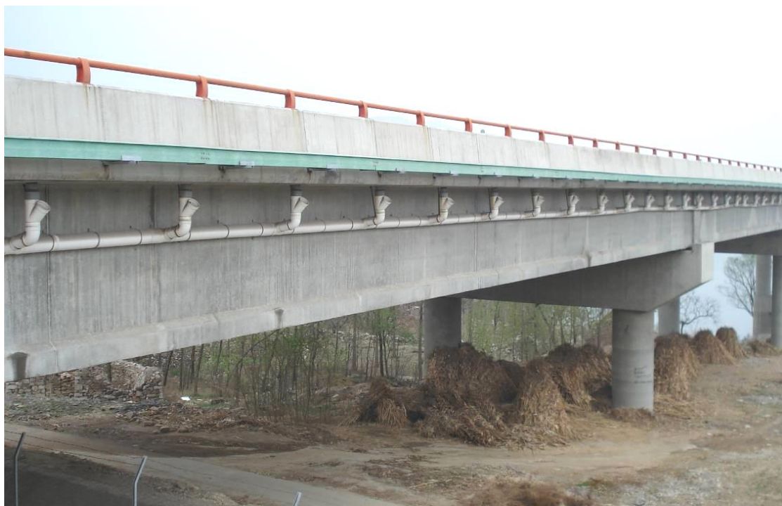
图 7.5-1 径流收集系统实景照片
