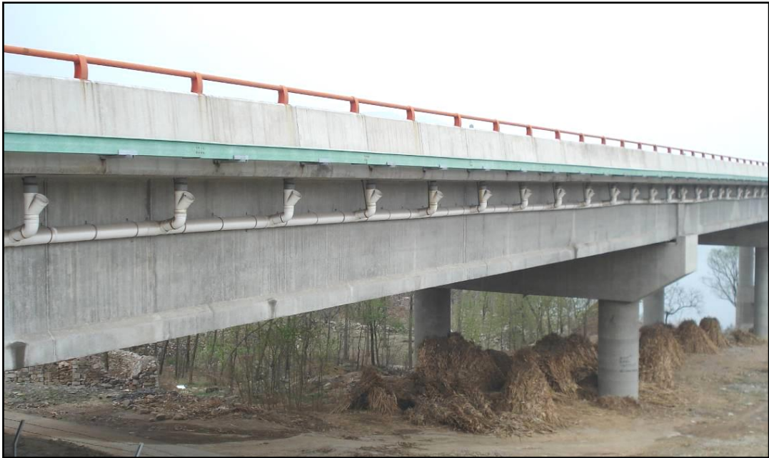
图 3.8-2 径流收集系统实景照片
