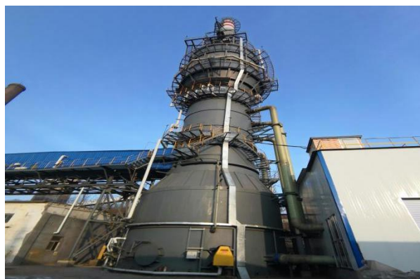
脱硫除尘、排气筒
