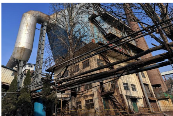
四电场静电除尘器
